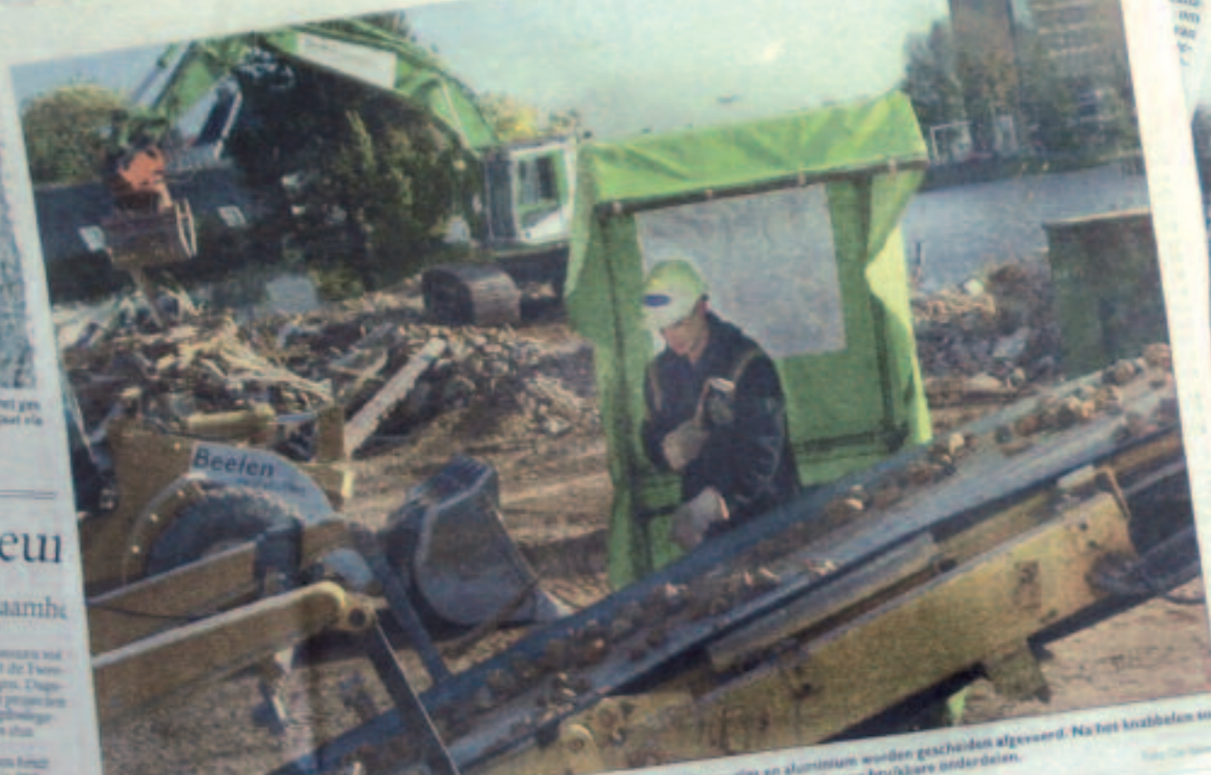
Beelen Sloopwerkzaamheden aan de voormalige Mariastichting in Haarlem. Het is een vakkundig proces dat wordt uitgevoerd door de slooporganisatie Sloopwerkzaamheden Haarlem (SWH).
