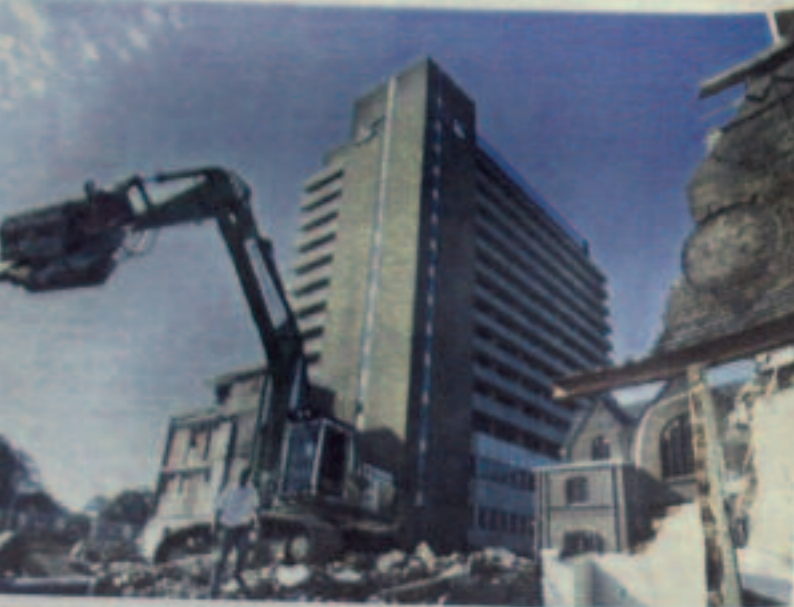
De sloop van de voormalige Mariastichting. Een kraanarm wordt hier al afgevoerd.
